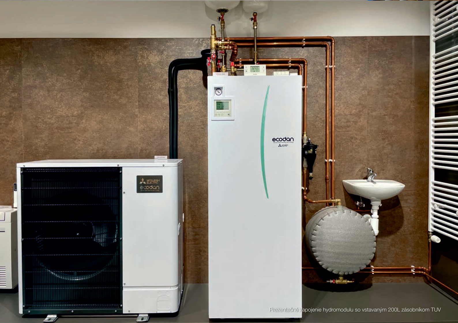
Zobrazenie inštalácie nástenného hydromodulu s externým zásobníkom TUV a akumuláčnou nádobou
